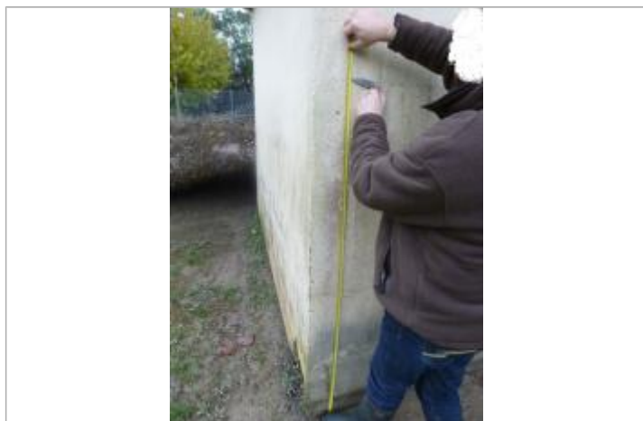
Trace de laisse mur - Photo ©DDT47
