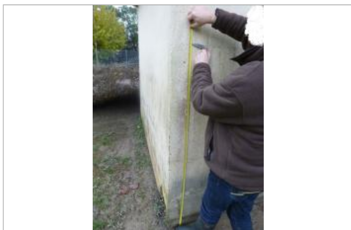
Trace de laisse mur - Photo ©DDT47
