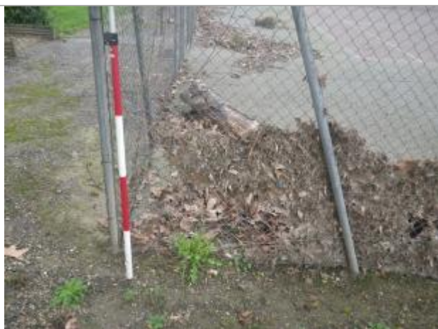
Débris végétaux grillage - Photo ©AGERIN
