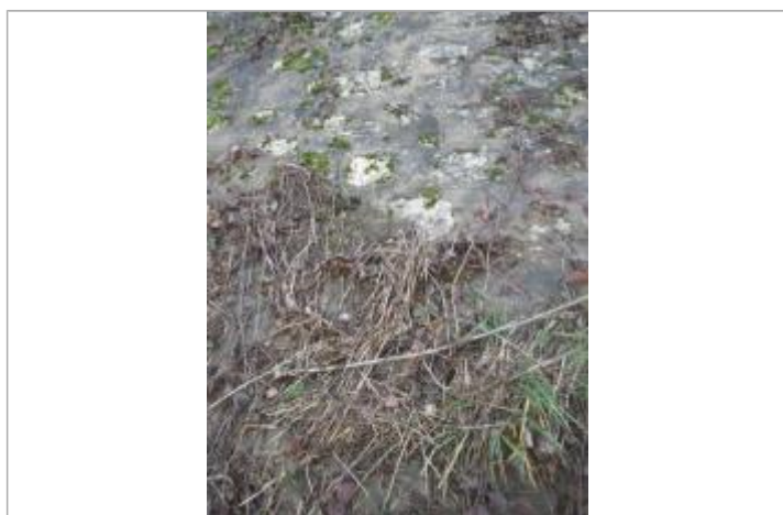
Débris végétaux sur muret - Photo ©AGERIN
