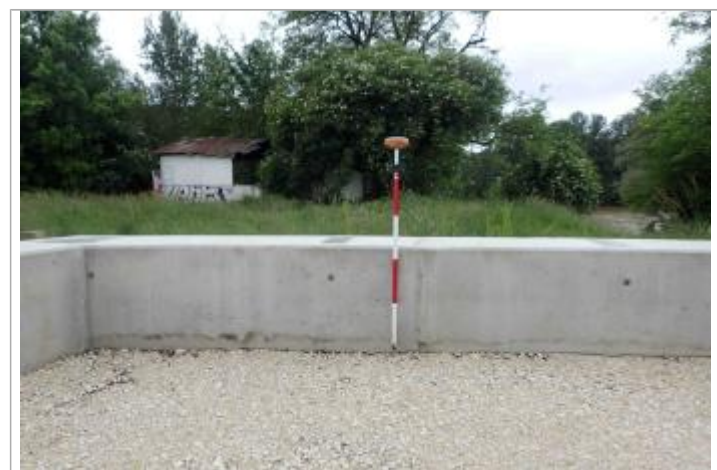
Laisse inondation sur le mur - Photo ©AGERIN
