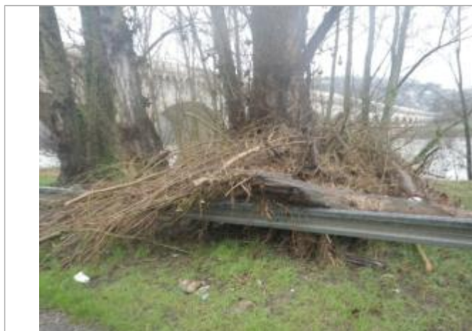
Débris végétaux sur barrière - Photo ©AGERIN
