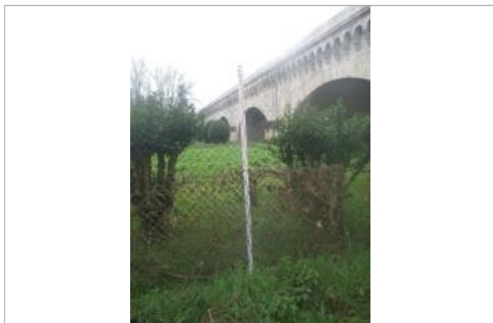
Débris végétaux sur grillage - Photo ©AGERIN
