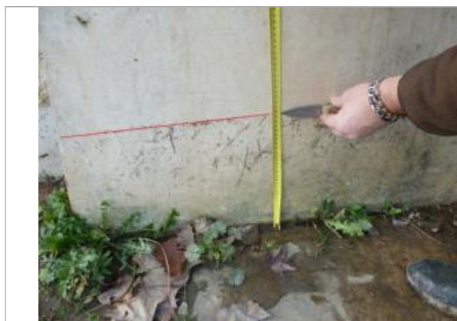
Laisse d'inondation sur le mur - Photo ©DDT
