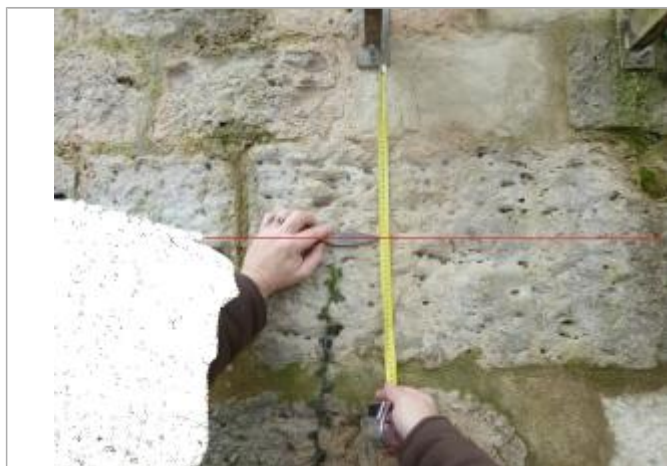
Laisse de crue sur le mure de la pile rive gauche - Photo ©DDT47
