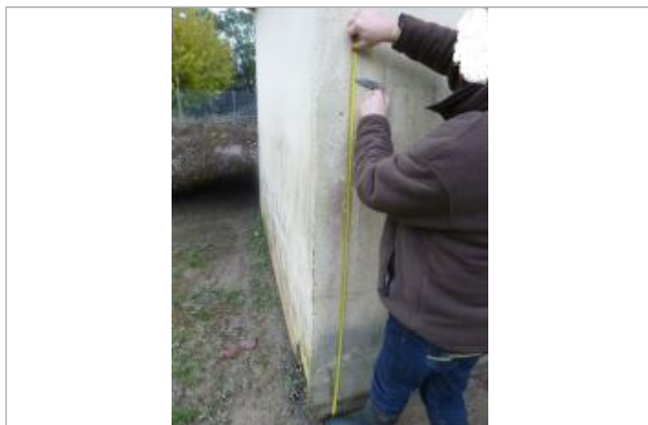
Trace de laisse mur - Photo ©DDT47
