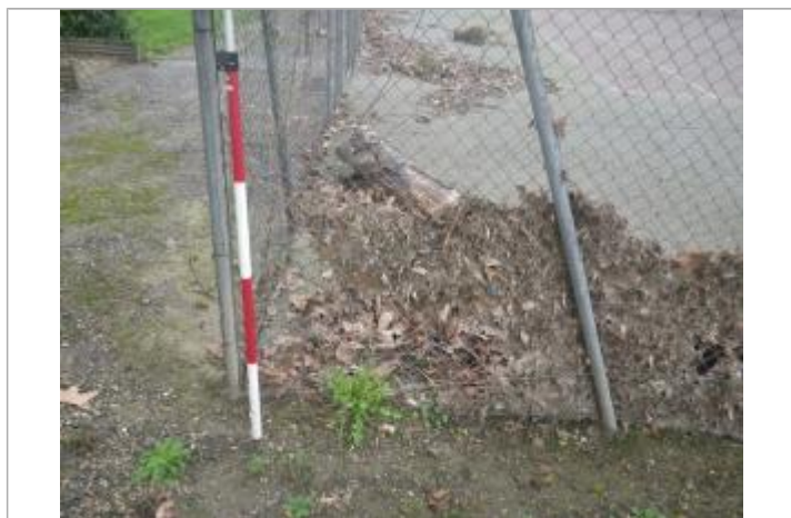
Débris végétaux grillage - Photo ©AGERIN
