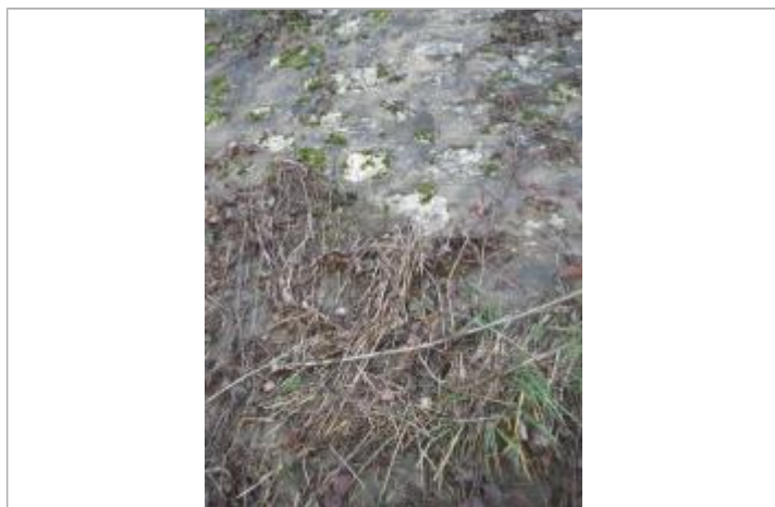
Débris végétaux sur muret - Photo ©AGERIN
