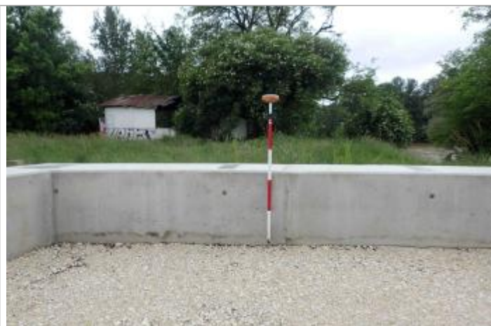
Laisse inondation sur le mur - Photo ©AGERIN
