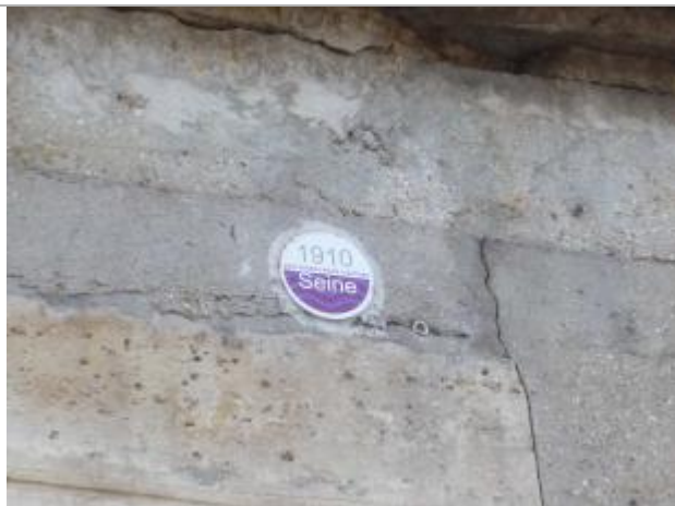
repère de crue posé par l'EPTB Seine Grands Lacs
