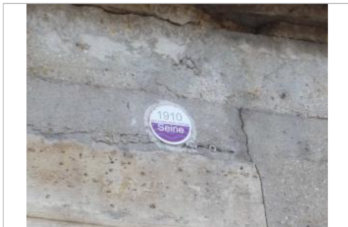
Repère de crue 100ale
