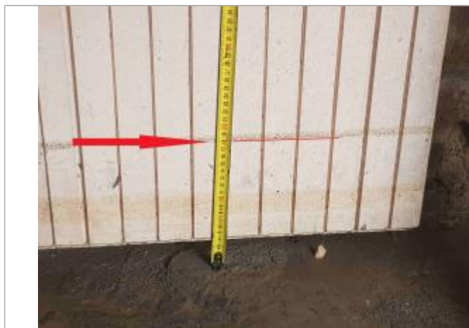
Laisse de crue sur porte du garage à 18 cm/sol
