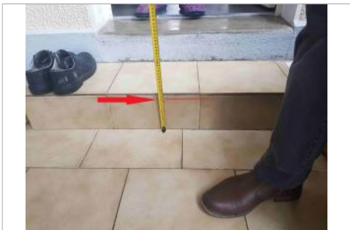
Laisse de crue au niveau du haut de la première marche dans la véranda à 15 cm/sol
