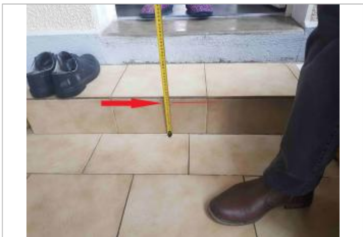
Laisse de crue au niveau du haut de la première marche dans la véranda à 15 cm/sol
