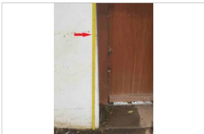
Laisse de crue sur porte du garage à 90 cm/sol
