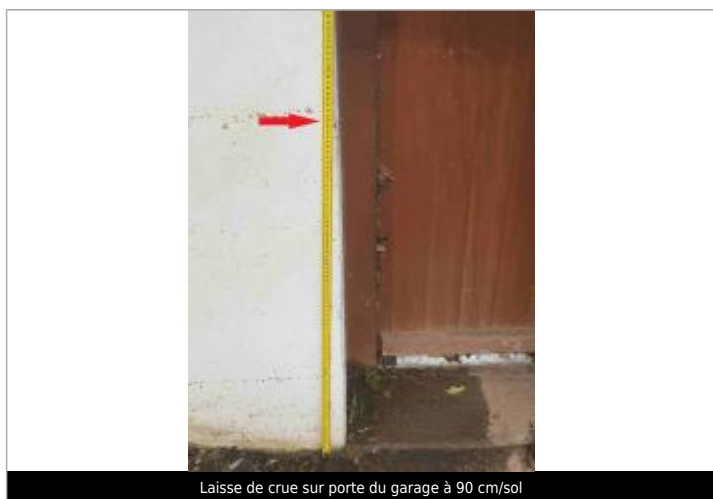
Laisse de crue sur porte du garage à 90 cm/sol
