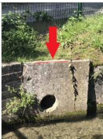
Laisse de crue au niveau du bord supérieur en ciment de la buse
