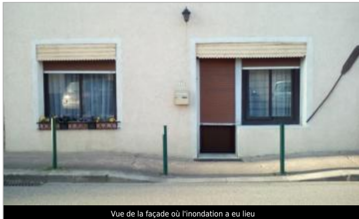
Vue de la façade où l'inondation a eu lieu
