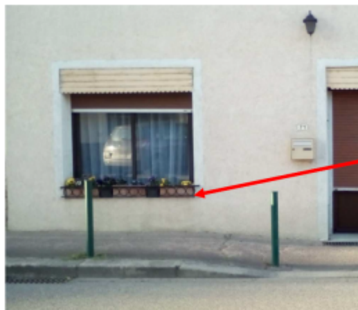
Inondation avec niveau d'eau montant jusque sous la fenêtre, le long du rebord.
