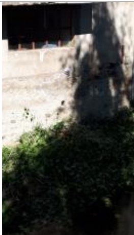
Vue éloignée du repère de crue
