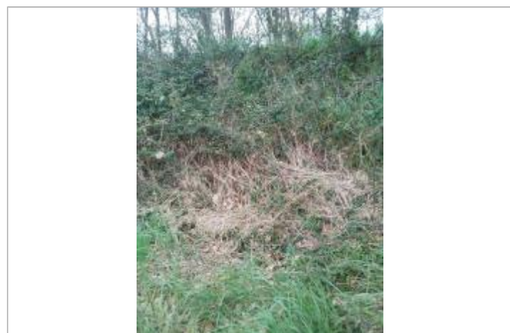
Débris végétaux sur la digue - Photo ©AGERIN
