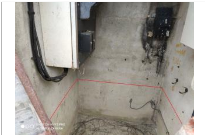
Cabanon électrique chemin le Rada - Photo ©AGERIN
