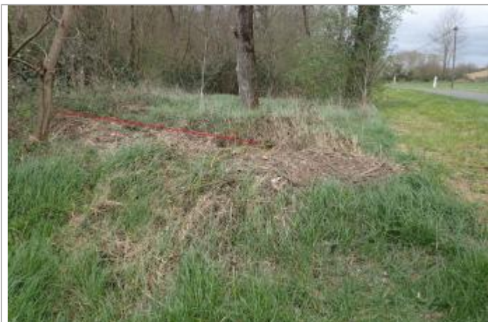
Talus au bord de la D40 - Photo ©AGERIN
