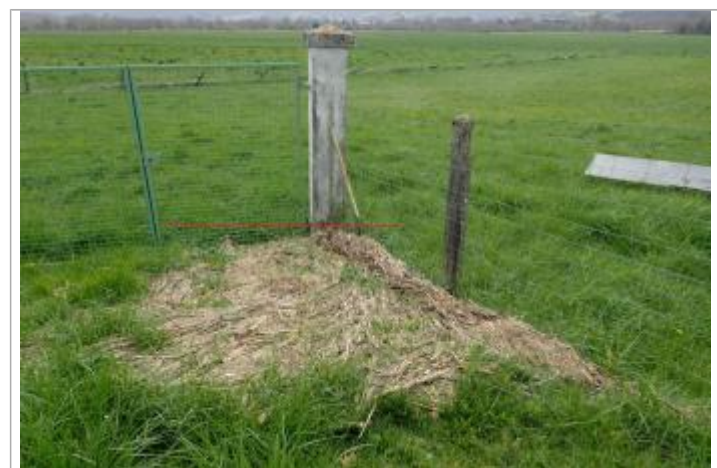
Débris végétaux au sol et contre le grillage - Photo ©AGERIN
