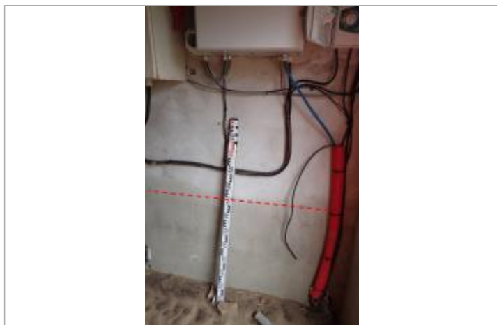
Laisse d'inondation sur le mur - Photo ©AGERIN
