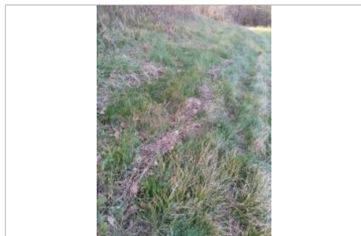
Débris végétaux sur la digue - Photo ©AGERIN
