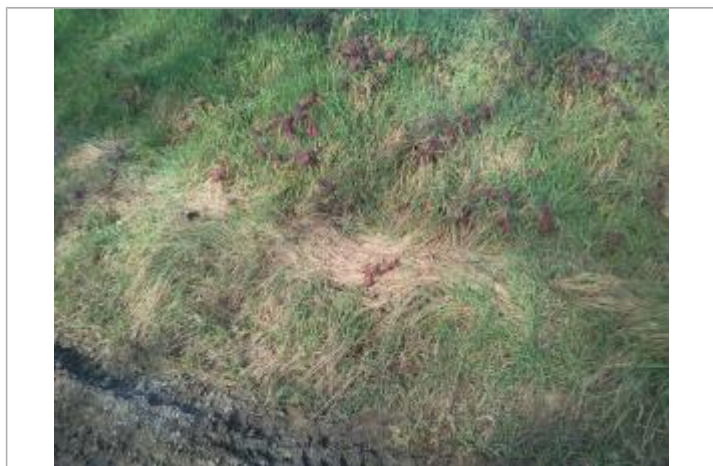
Laisse d'inondation sur la digue - Photo ©AGERIN
