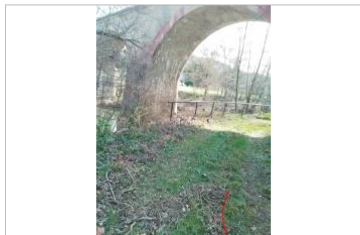
Débris végétaux au sol - Photo ©AGERIN
