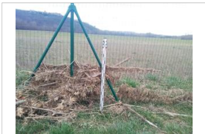
Laisse de crue sur le grillage - Photo ©AGERIN
