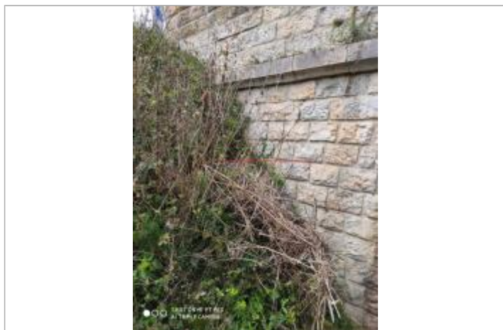
Laisse de crue culée du pont - Photo ©AGERIN
