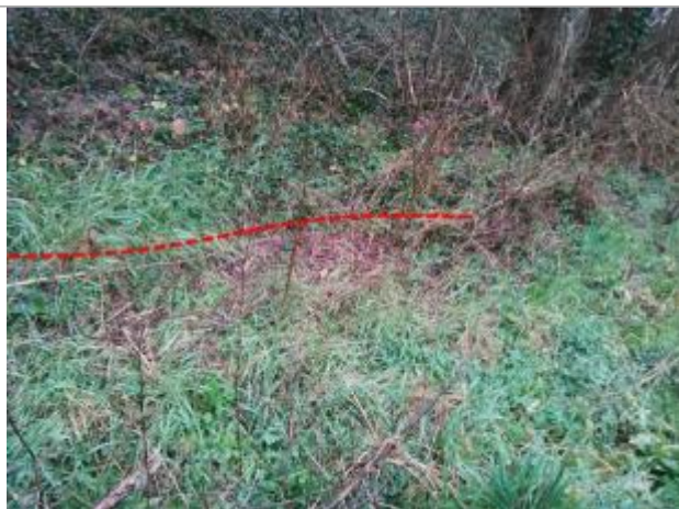
Débris végétaux sur la digue - Photo ©AGERIN
