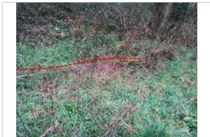
Débris végétaux sur la digue - Photo ©AGERIN
