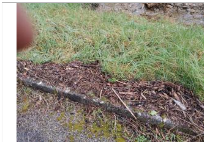
Débris végétaux sur le trottoir - Photo ©AGERIN
