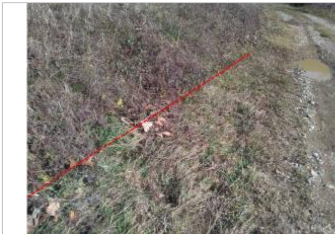
Débris végétaux sur la digue - Photo ©AGERIN
