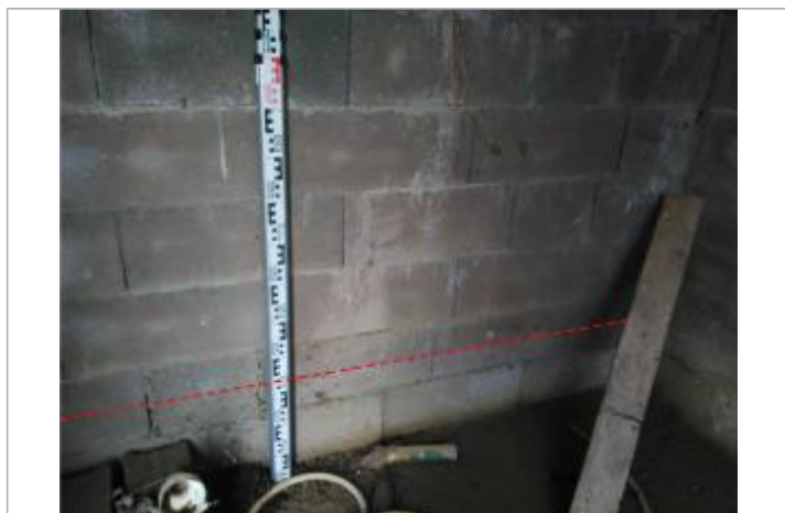
Laisse mur - Photo ©AGERIN
