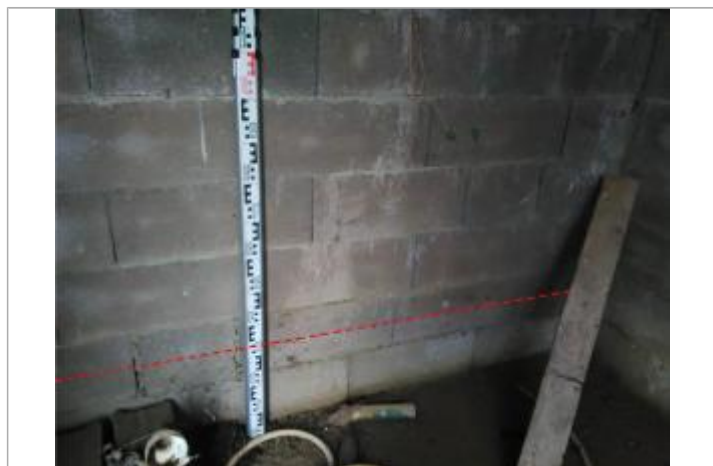
Laisse mur - Photo ©AGERIN
