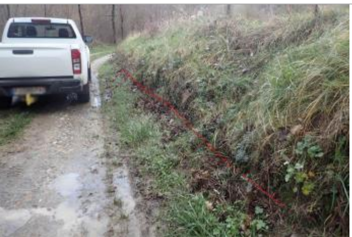
Débris végétaux sur le talus - Photo ©AGERIN
