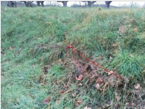
Débris végétaux sur la digue - Photo ©AGERIN
