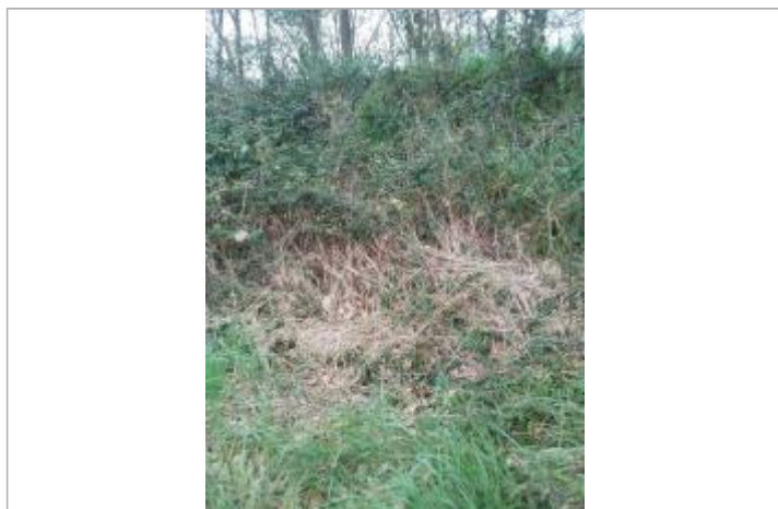
Débris végétaux sur la digue - Photo ©AGERIN
