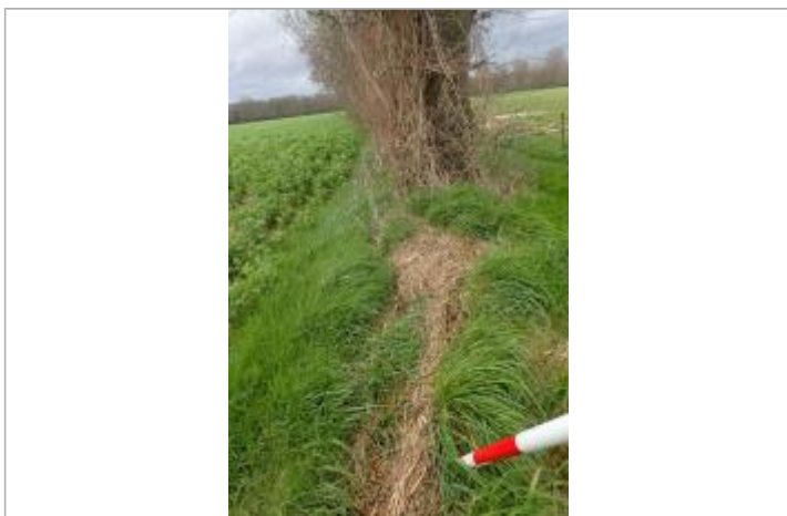
Débris végétaux en haut de digue - Photo ©AGERIN
