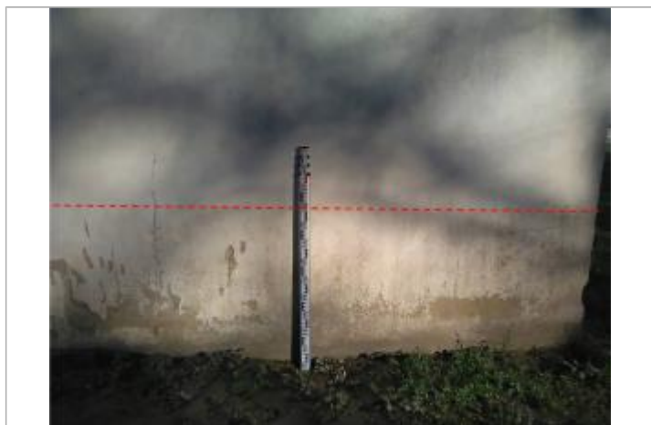
Laisse de crue sur le mur arrière de la station - Photo ©AGERIN
