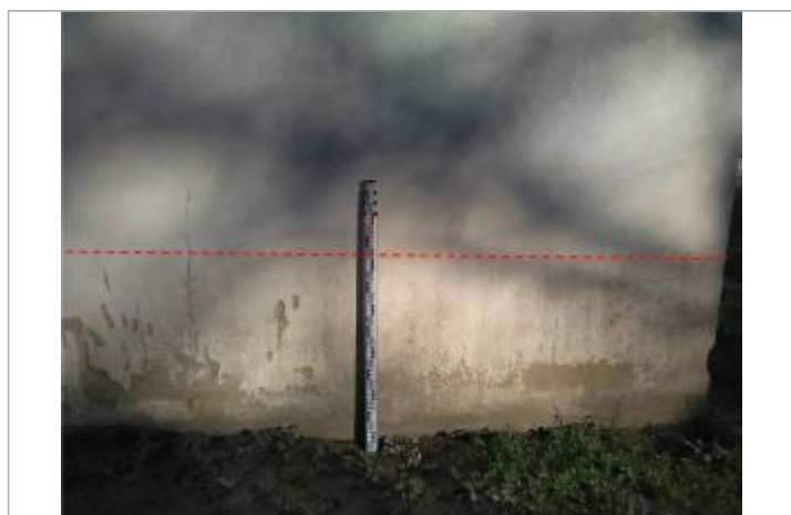
Laisse de crue sur le mur arrière de la station - Photo ©AGERIN
