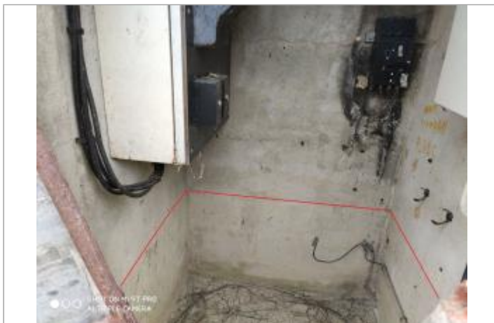
Cabanon électrique chemin le Rada - Photo ©AGERIN
