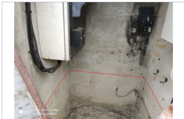
Laisse d'inondation à l'intérieur du cabanon- Photo ©AGERIN
