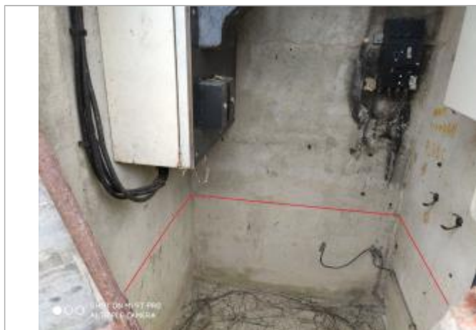
Laisse d'inondation à l'intérieur du cabanon- Photo ©AGERIN
