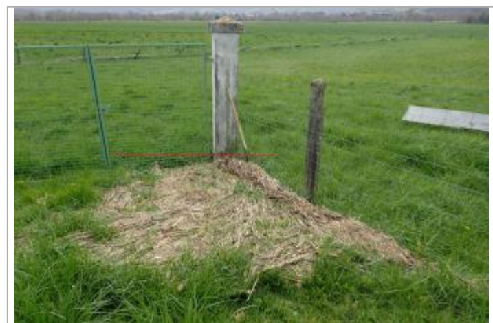
Débris végétaux au sol et contre le grillage - Photo ©AGERIN
