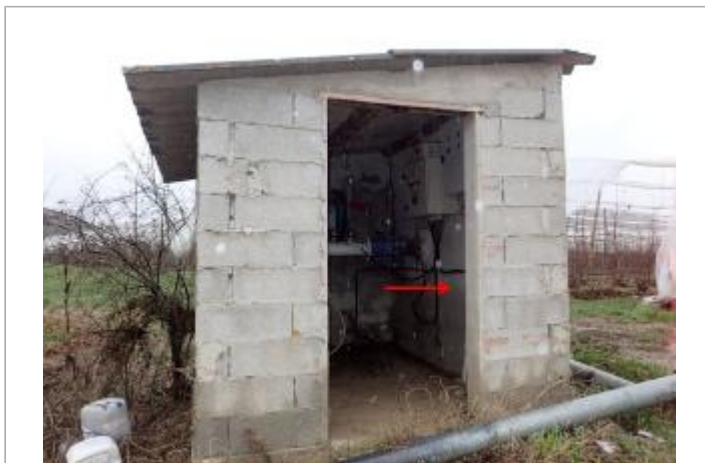
Cabanon station de pompage des vergers - Photo ©AGERIN
