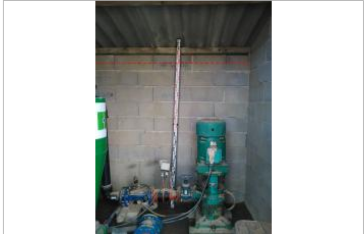
Laisse de crue sur le mur intérieur de la cabane - Photo ©AGERIN
