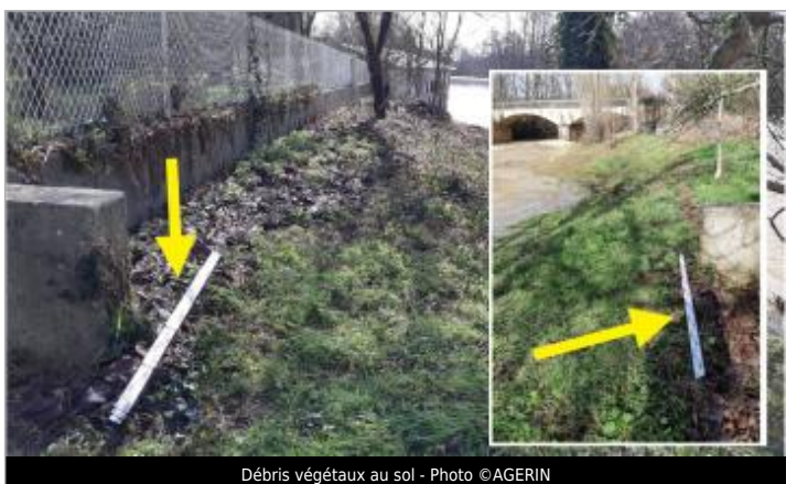
Débris végétaux au sol - Photo ©AGERIN
