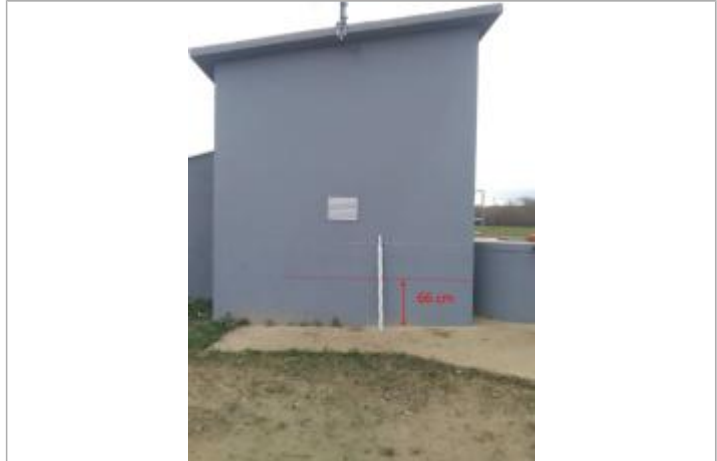
Laisse d'inondation sur le mur - Photo ©AGERIN
