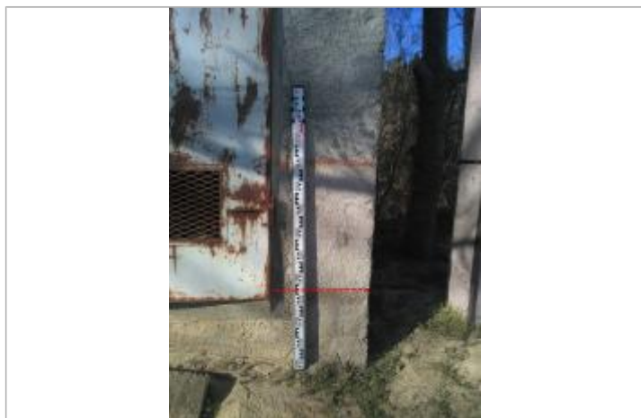
Laisse de crue sur le mur du cabanon - Photo ©AGERIN
