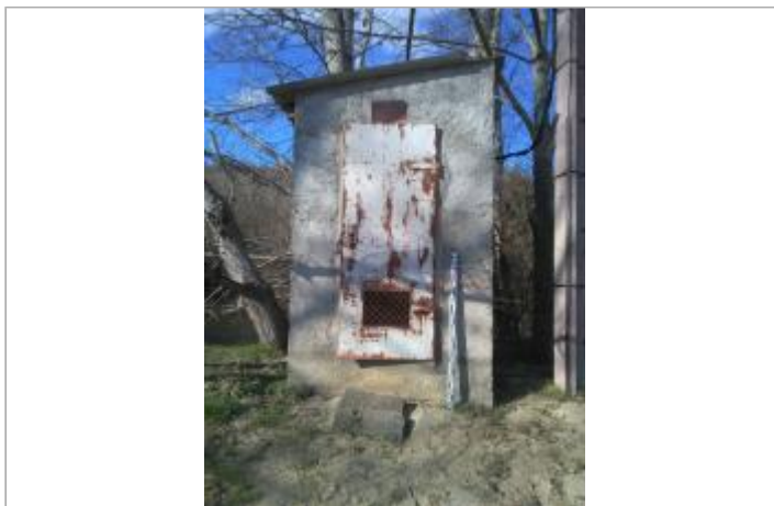
Cabanon de pompage plaine du Chapitre - Photo ©AGERIN
