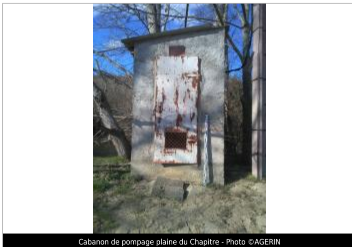
Cabanon de pompage plaine du Chapitre - Photo ©AGERIN
