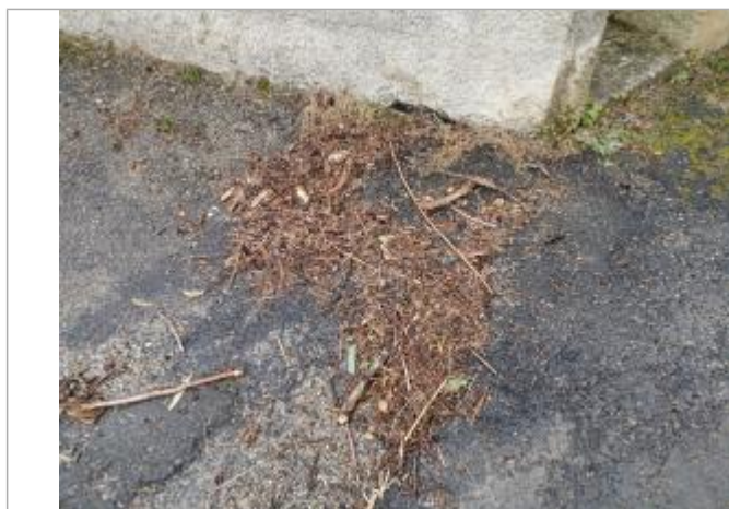
Laisse de crue au sol - Photo ©AGERIN
